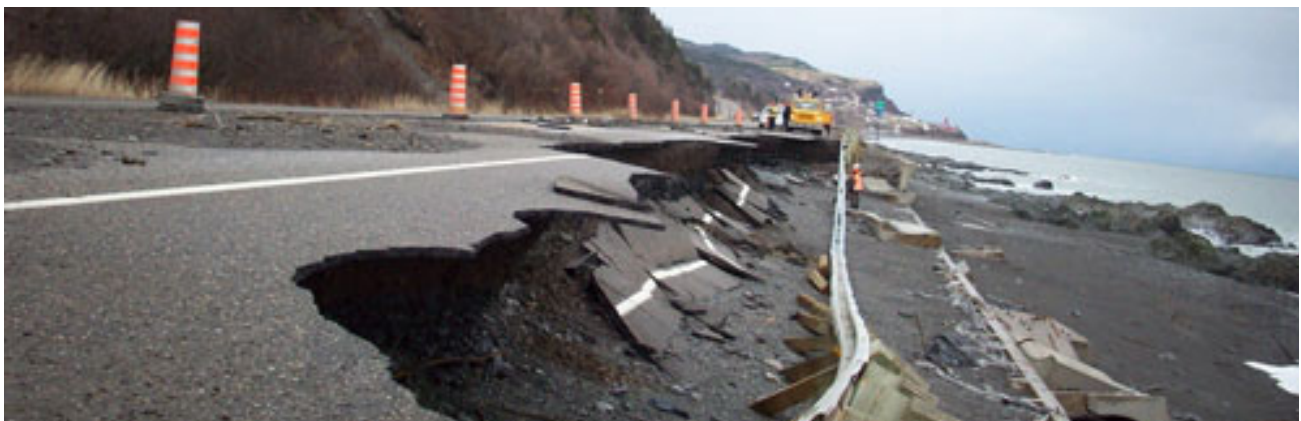
Figure 11: Major deterioration of the Route 132 roadway in the Gaspé Peninsula, in December, 2010. (Source: Ministère des Transports, de la Mobilité durable et de l'Électrification des transports du Québec)
