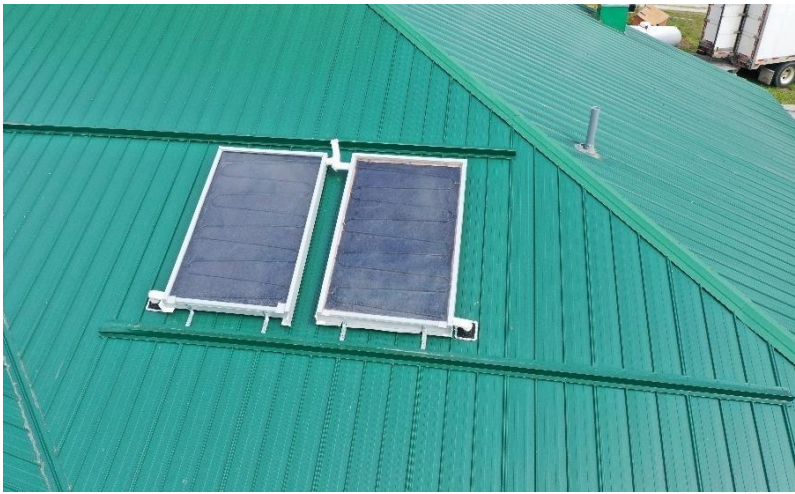
Figure 90 : Vue du haut de l'installation de démonstration montrant les capteurs thermiques solaires à la Première Nation des Cris de Missanabie, mai 2022.
