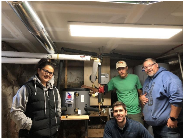
Figure 86 : Vue de face de l'installation de démonstration montrant le réservoir à vidange autonome, le contrôleur et le nouveau réservoir de stockage électrique solaire au Wahkohtowin Innovation Centre, Chapleau, Ontario, 2021.
