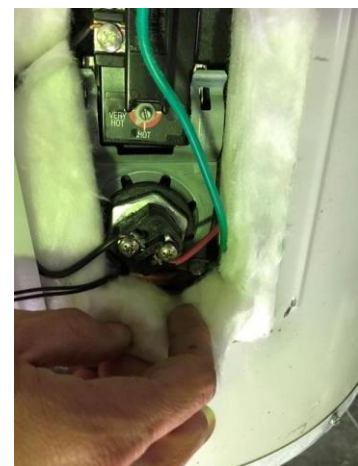
Figure 83 : Retrait du couvercle d'accès du bas pour exposer la paroi du réservoir de stockage et les fils de l'élément de chauffage inférieur
