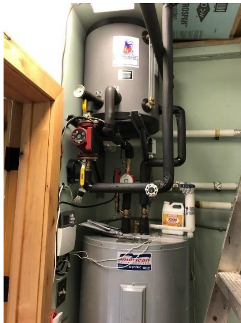
Figure 89 : Vue de face de l'installation de démonstration montrant le nouveau réservoir de stockage électrique solaire, le réservoir à vidange autonome et le contrôleur à la Première Nation des Cris de Missanabie, mai 2022.
