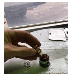
Figure 77 : Retrait de la pièce rapportée du capteur de chaleur de l'arrivée d'eau froide
