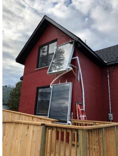
Figure 88 : Vue latérale de l'installation de démonstration montrant les capteurs solaires au Wahkohtowin Innovation Centre, Chapleau, Ontario, 2021.
