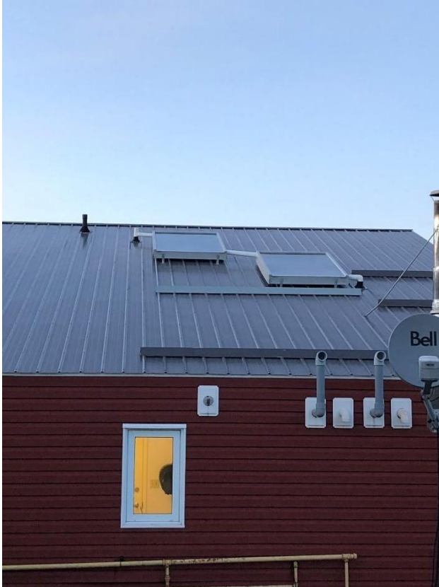
Figure 91 : Vue de face de l'installation de démonstration montrant les capteurs thermiques solaires à la Première Nation des Cris de Chapleau, Mukeso House, septembre 2022.
