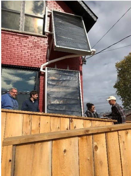
Figure 87 : Vue de face de l'installation de démonstration montrant les capteurs thermiques au Wahkohtowin Innovation Centre, Chapleau, Ontario, 2021.
